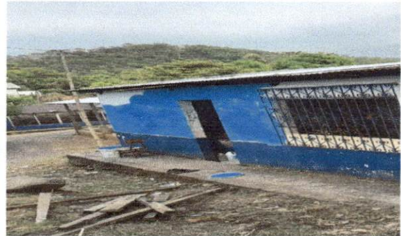
Foto 4: La puerta del modulo necesita ser sustituido
